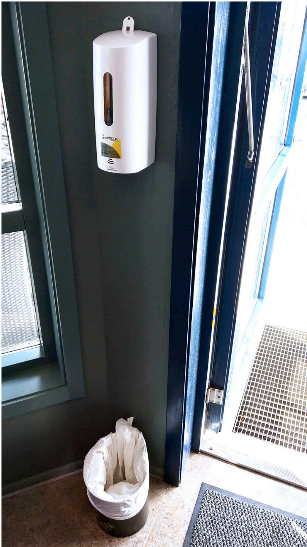
Plassering av avfallsbøtte rett under alkoholholdig desinfeksjonsmiddel. Foto: Arnstein Fedøy
